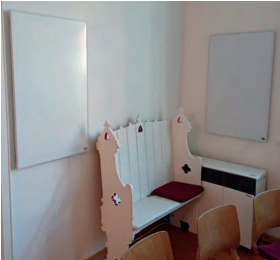
Die neuen Heizplatten in der Kapelle Willensen (Foto: KV)
