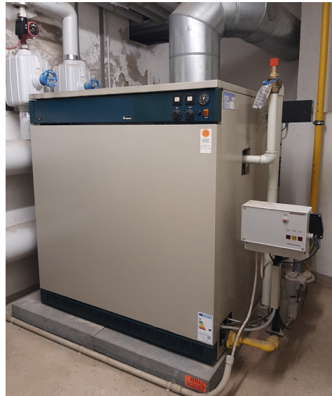
Heizung in der Kirche (Foto: K. Brakebusch)
