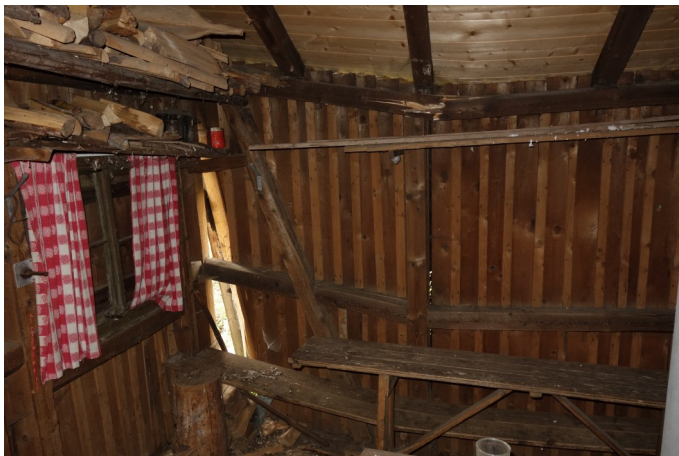
Schlechter Zustand innen - Foto: I. Schumann
