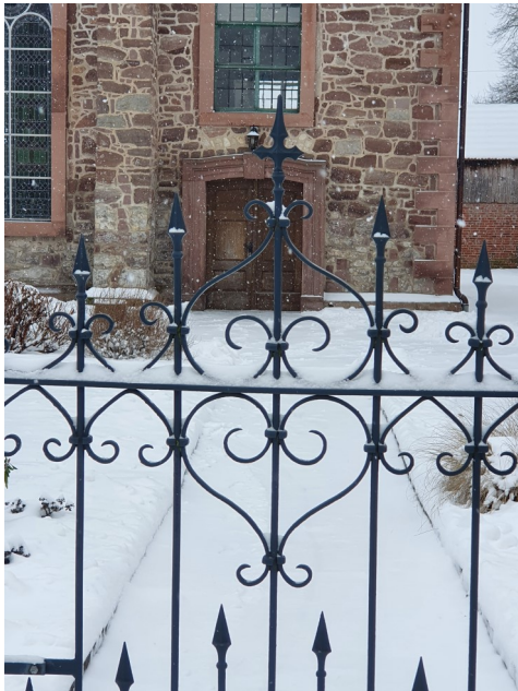
Die Instandsetzung des Kirchenzauns ist erforderlich. (Foto: S. Schimpfhauser)
